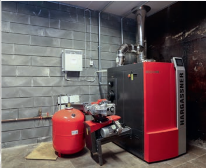
Den totale vannmengden i anlegget til Lars Ole Bjørnbet er 3000 liter. Både Bjørnebet og Kvam har klargjort fyrrommene for flere varmesløyfer.
