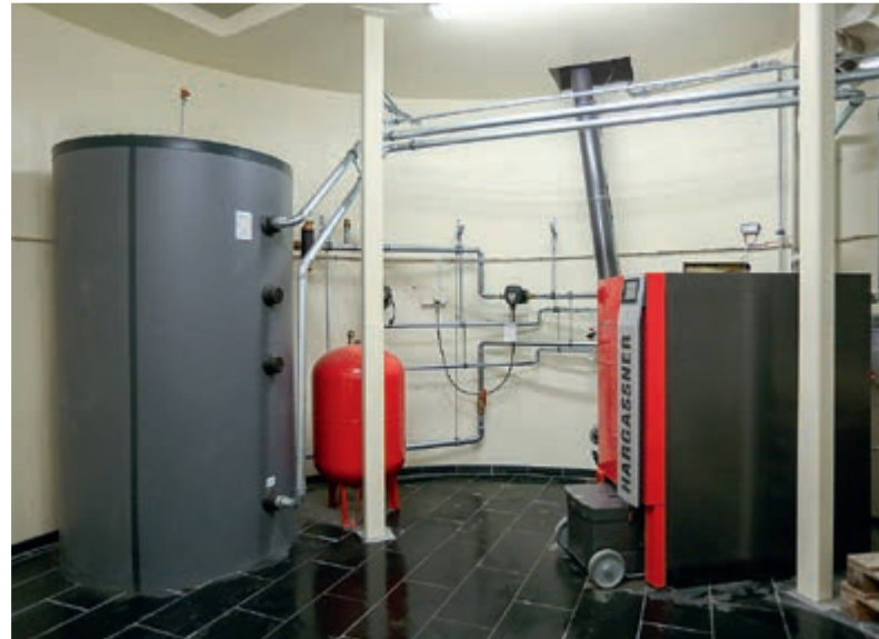
Jan Ivar Kvam har støpt etasjeskille i tårnsiloen, og plassert fyrrommet i underetasjen.
