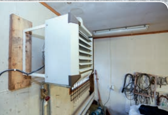
En av tre viftekonvektorer i pelseriet hos Lars Ole. Slike kan også plasseres andre steder, for eksempel i verksted eller garasje.
